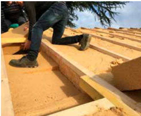
Une nouvelle charpente isolée par 360 mm de fibre de bois est venue couvrir les anciens chevrons.
