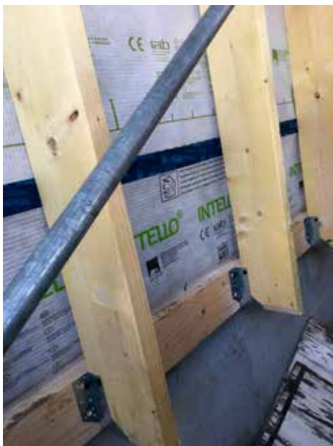
Le ceinturage de la maison permet de porter la nouvelle ossature. Le frein-vapeur enveloppe la partie existante.
